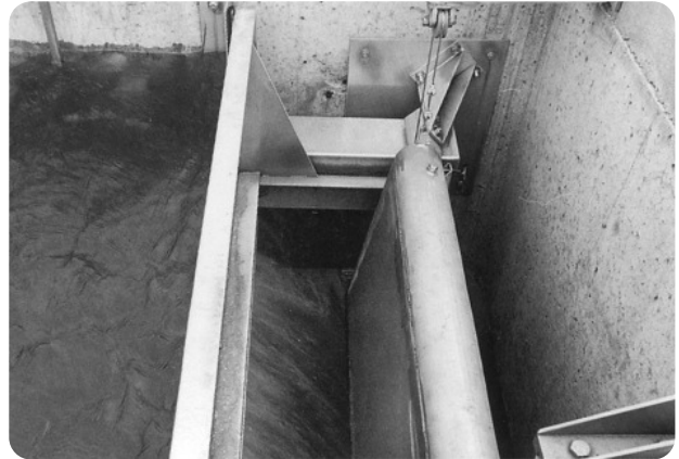
RÜ/Stauschild bei Erreichen des max. Stauziels (Entlastungsfall)
